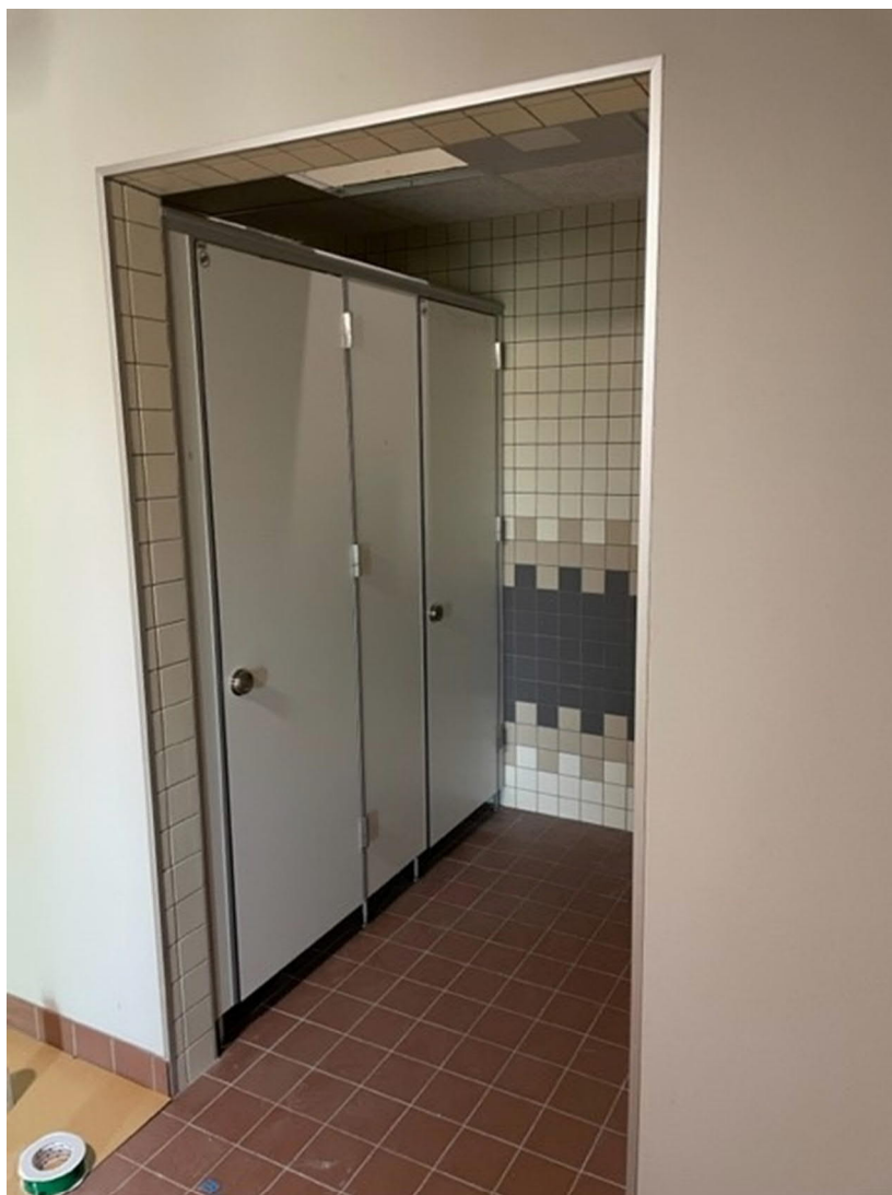
Duschbås i ett av omklädningsrummen.
