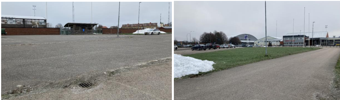
Figur 4: Bilderna visar utlopp från skyfallsytta på fotbollsplan genom entréer i mur. Framför finns rännstensbrunn och gräsyta.
