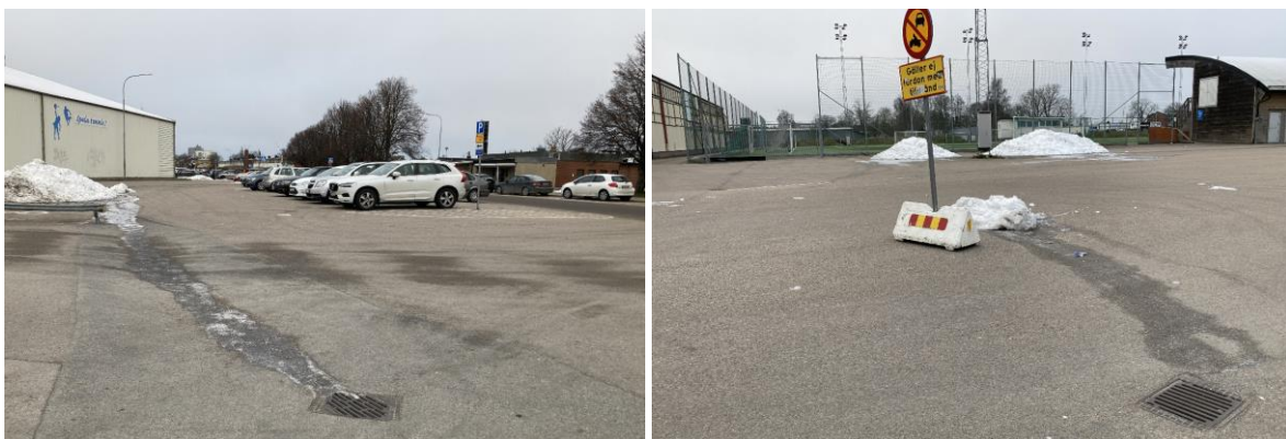
Bilderna visar asfalterade ytor och parkeringar med avrinning mot rännstensbrunnar i lågpunkt.
